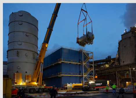
Bouwen aan de DeNOx De eerste delen staan, de ozongenerator zit erin en nu zijn we druk bezig met een staalconstructie van 1 miljoen kg voor de schoorsteen. Ons doel? Ongeveer 80% minder stikstofuitstoot van de Pelletfabriek. Bekijk de video: BIG, BIGGER, BIGGEST
